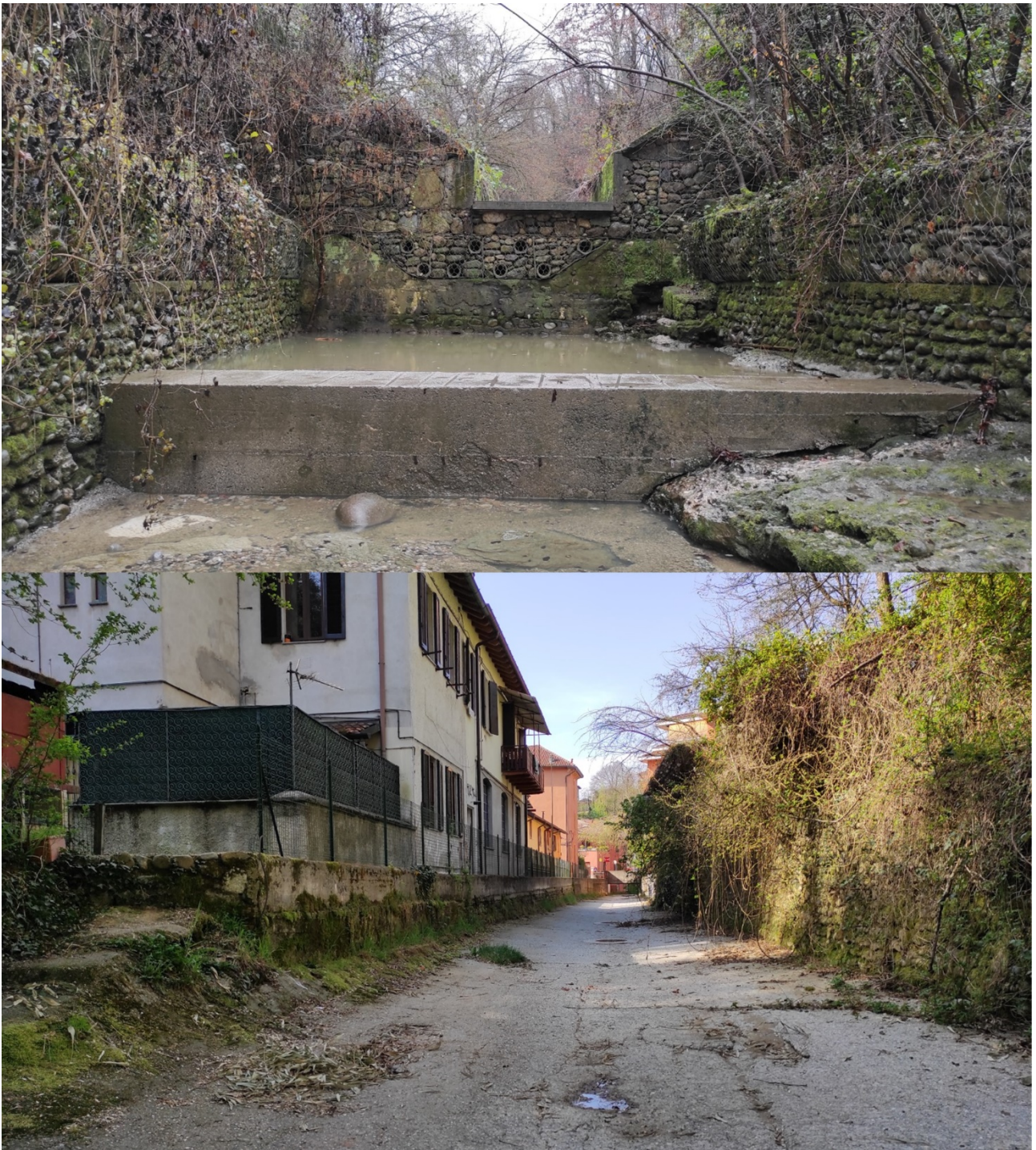
Figura 8: briglia di consolidamento in gabbioni (alto) a monte del tratto terminale dell'alveo, artificializzato in cls e muratura (basso) all'interno della frazione di ponte Albiate
